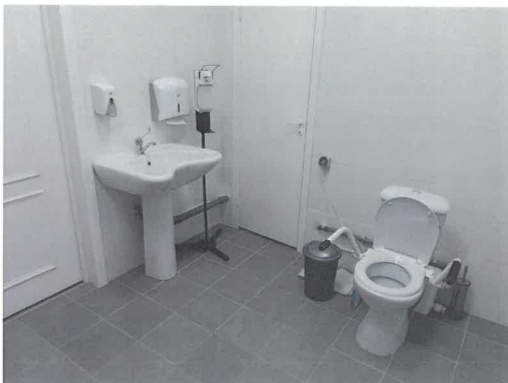
Оборудование санузла для маломобильных посетителей
